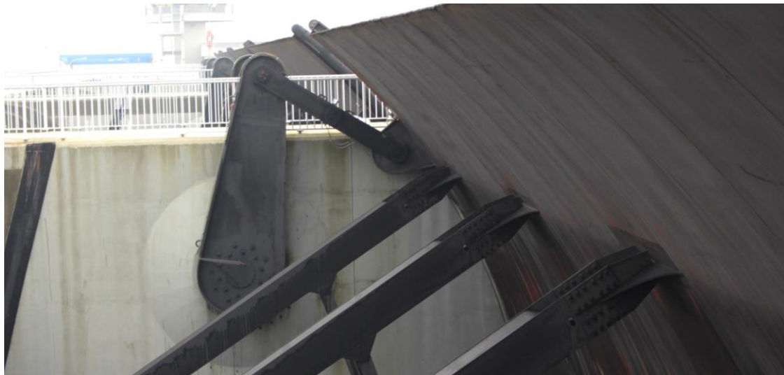
Abbildung 17: Torantrieb des Eidersperrwerkes (Foto: H. Petschull)
